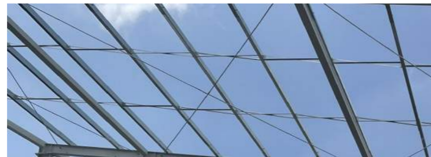
HỆ GIẪNG MÁI (GIẪNG ROD / CÁP / THANH GIẪNG XÀ GỖ | SAG ARRESTOR / CABLE / ROD BRACING)
